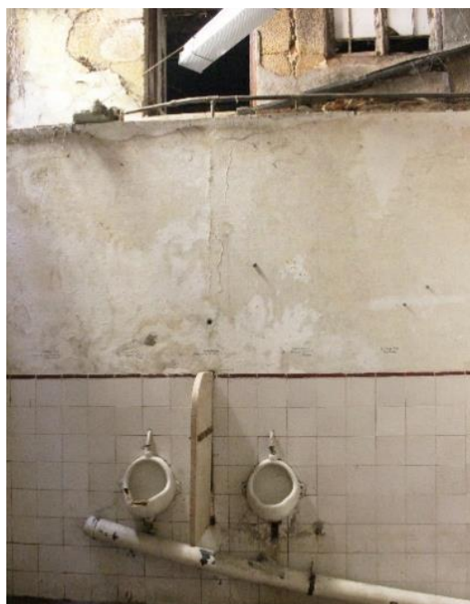
Imagem 112 - Patologias verificadas ao nível das paredes e louças sanitárias
