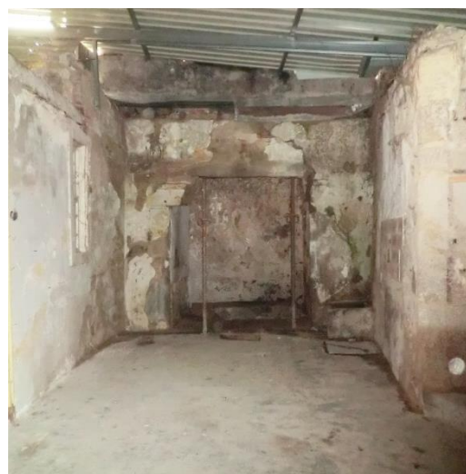
Imagem 119 - Patologias verificadas ao nível das paredes, pavimento e cobertura
