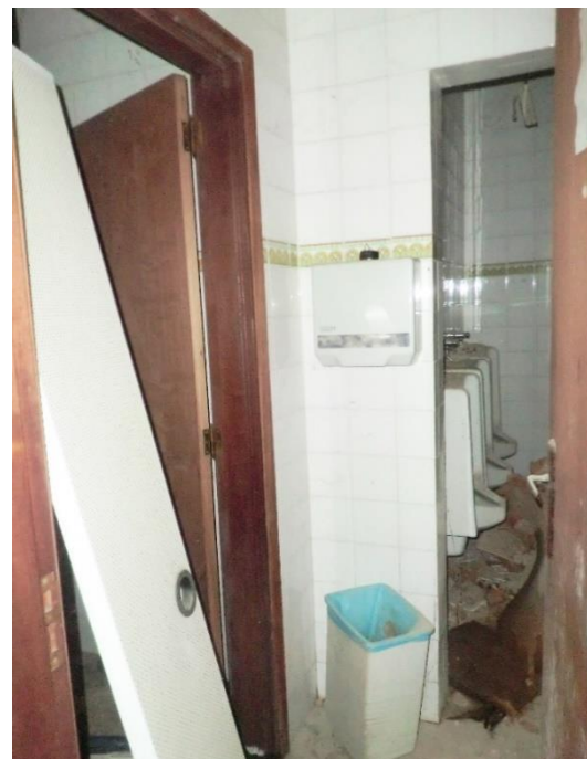
Imagem 109 - Patologias verificadas ao nível do pavimento, paredes e carpintarias
