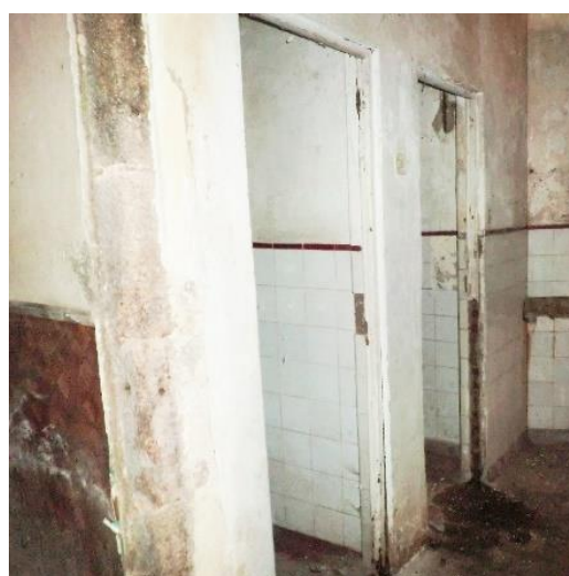
Imagem 111 - Patologias verificadas ao nível do pavimento e paredes
