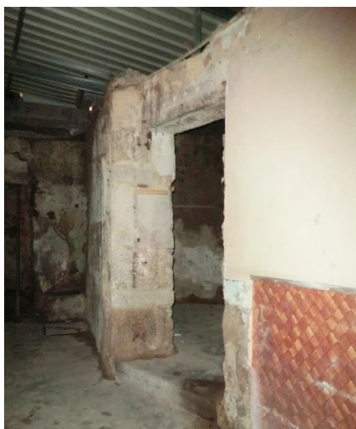
Imagem 120 - Patologias verificadas ao nível das paredes, pavimento e cobertura
