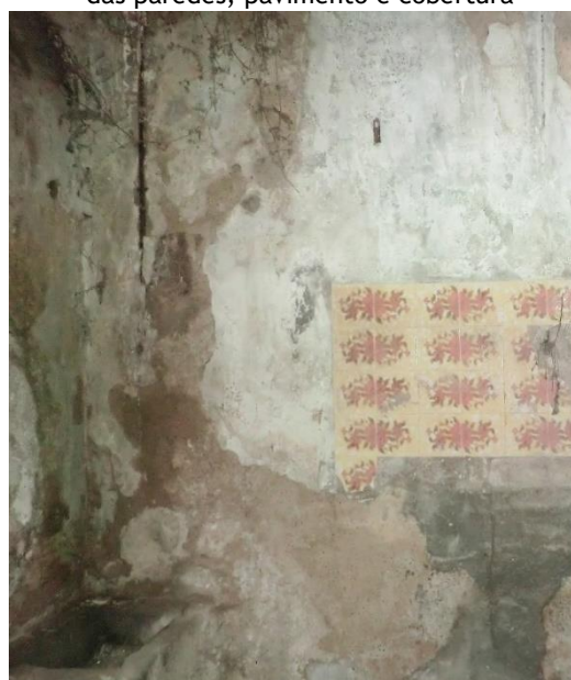
Imagem 121 - Patologias verificadas ao nível das paredes
