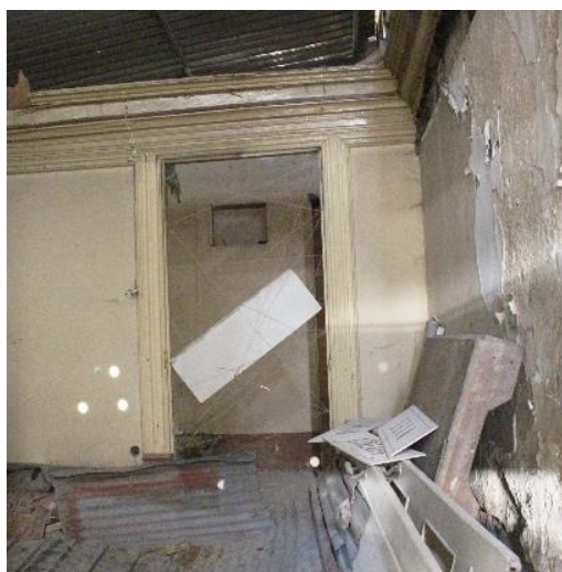
Imagem 117 - Patologias verificadas ao nível das paredes, pavimento e cobertura
