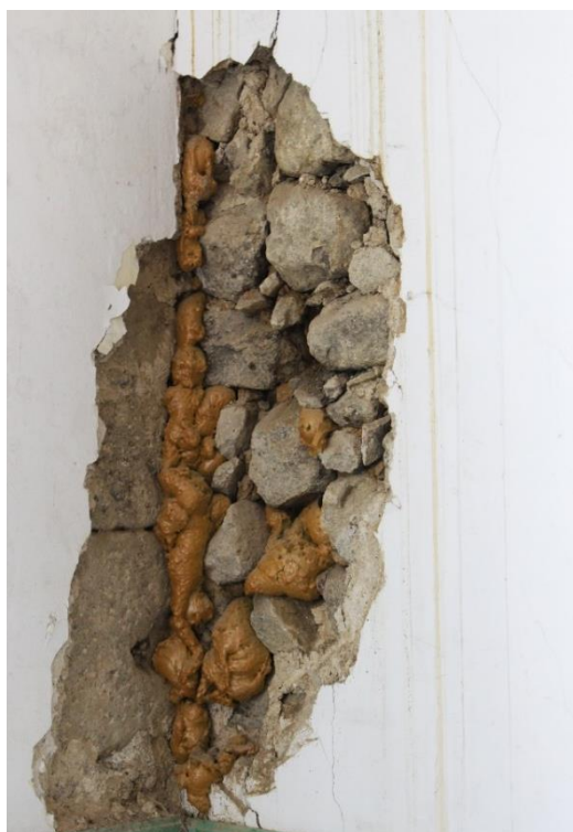
Imagem 101 - Patologias verificadas ao nível das paredes
