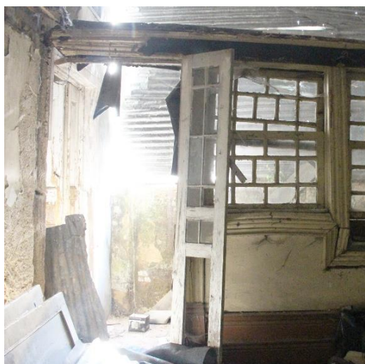
Imagem 116 - Patologias verificadas ao nível das paredes, pavimento e cobertura
