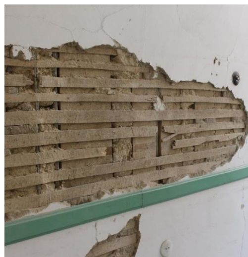
Imagem 100 - Patologias verificadas ao nível das paredes
