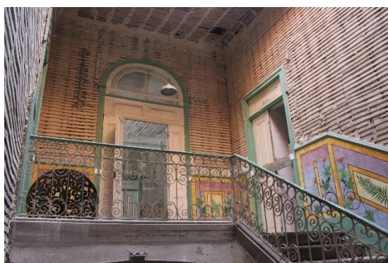
Imagem 94 - Patologias verificadas ao nível das paredes e da estrutura de madeira do teto no hall superior da escadaria, piso 1
