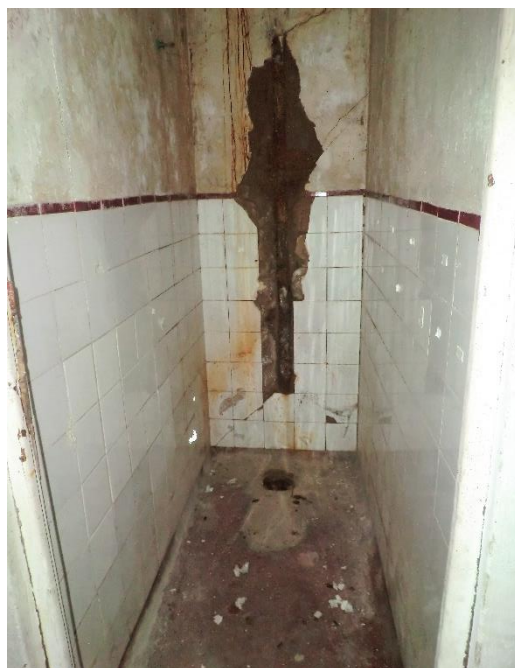
Imagem 113 - Patologias verificadas ao nível das paredes e pavimento
