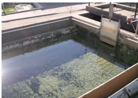
Figura 2.8 – Exemplo de filtros abertos de areia, de fluxo vertical e lavagem automática – ETA da Capinha.
