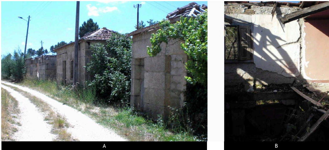
Figura 39 - Conjunto das casinhas (A) e o seu estado de degradação (B).
