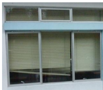
Figura 4.2.1.7 - Janelas em alumínio exteriores
