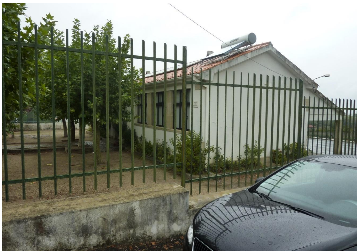
Figura 4.2.1.6 - Escola Peraboa, Covilhã - Utilização de Painéis Solares
