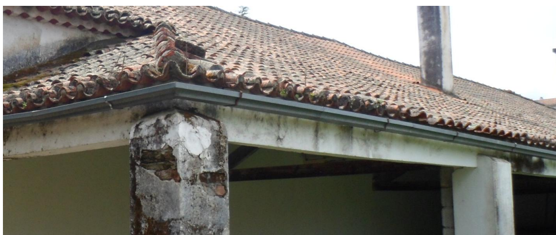
Figura 56 - Degradação de um dos pilares de sustentação do recreio coberto.
