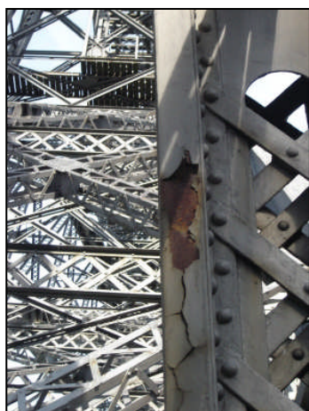
Fig. 248, Pormenor da Ponte Maria Pia. Oxidação da estrutura.
