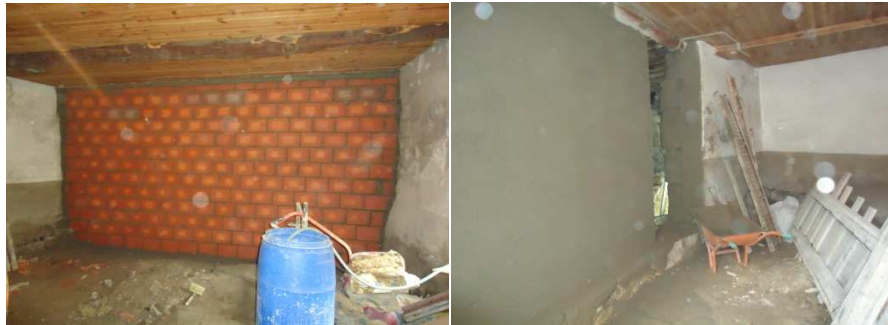
Foto 4.11 - Tratamento das paredes no piso 0, através de execução de pano de alvenaria (direita) e regularização através da aplicação de argamassa (esquerda)
