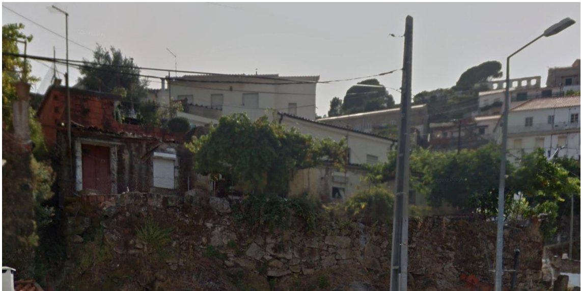
Imagem 43: Fotografia de uma (barraca) junto à via principal, na Rua da Indústria-Cantar Galo
