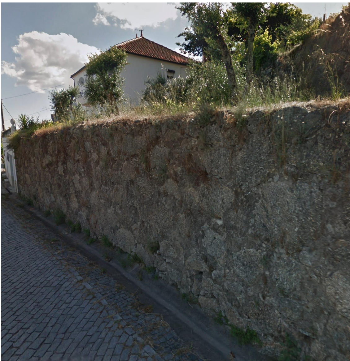
Imagem 53: Fotografia de dois muros de suporte, inferior e posterior, junto à estrada na, Rua do Cruzeiro-Vila do Carvalho.
