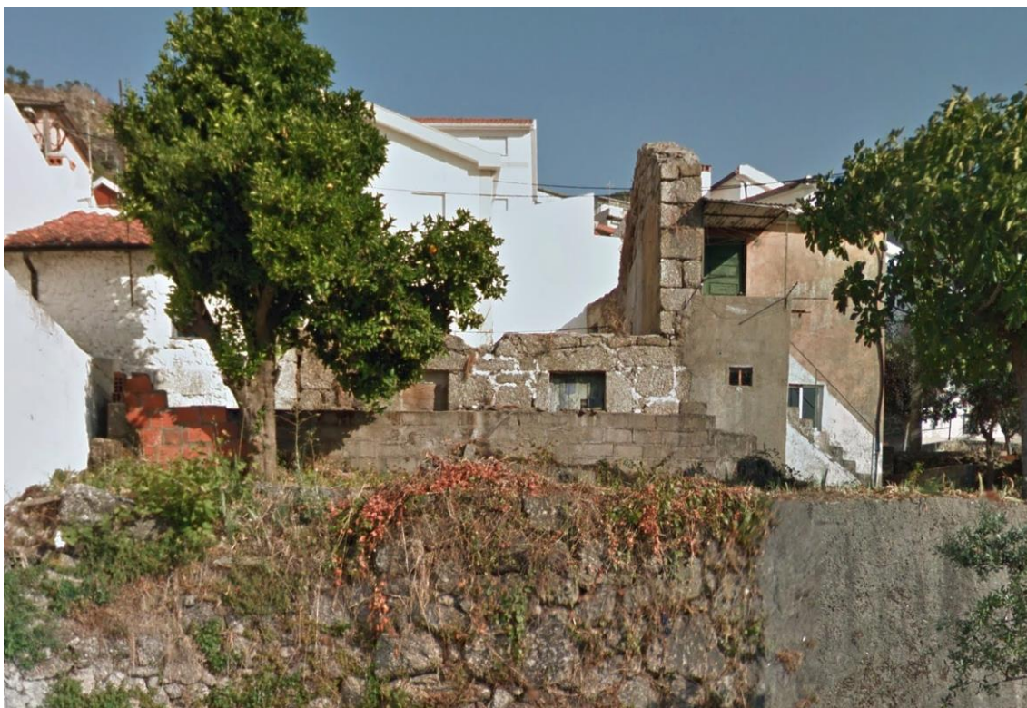
Imagem 42: Fotografia de casa em ruína, junto à estrada na via principal da Freguesia, na Rua 30 de Junho-Cantar Galo
