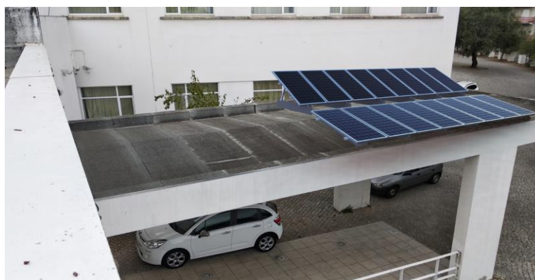
Figura 3.14 - Painéis PV instalados no topo da entrada da Residência Universitária do Sineiro.
