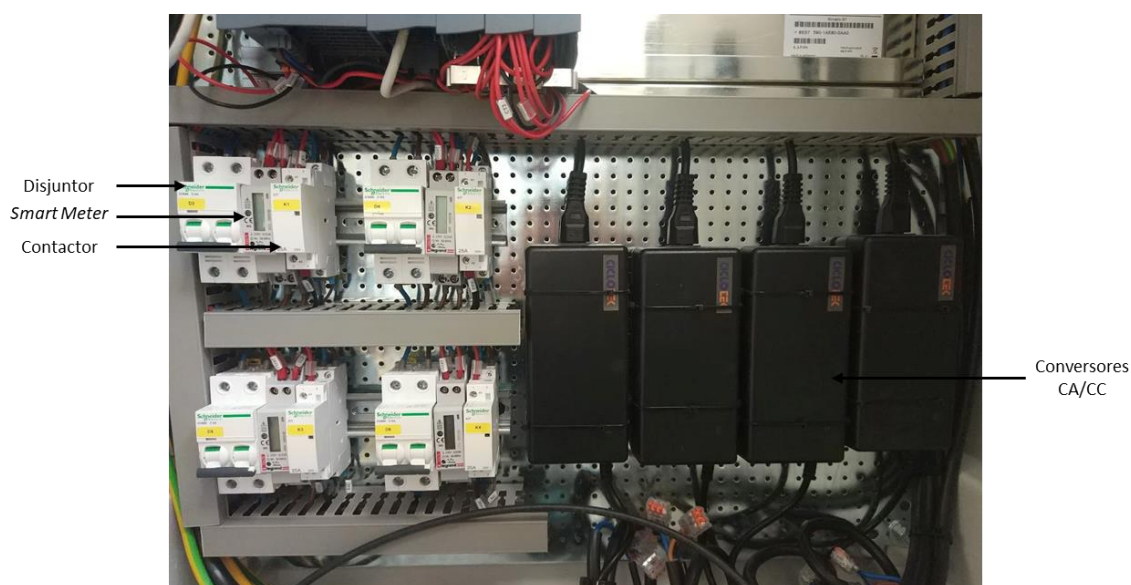
Figura 4.8 - Circuito de potência instalado no quadro elétrico.
