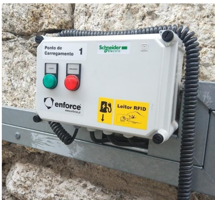
Figura 4.7 - Ponto de carregamento com leitor RFID no interior e leds indicativos de funcionamento.
