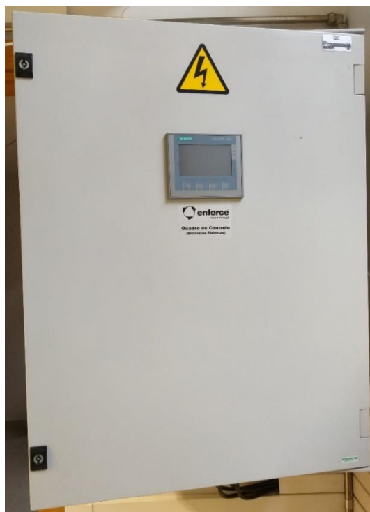
Figura 4.9 - Quadro elétrico com instalação da consola HMI na porta frontal.
