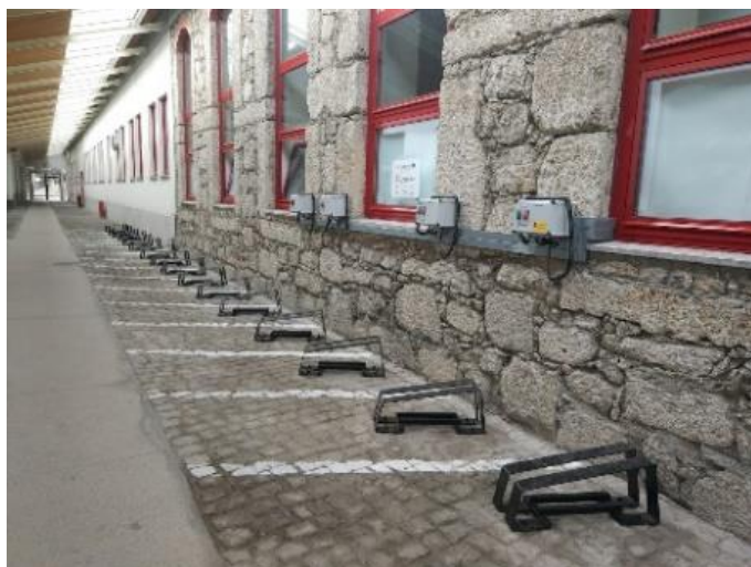
Figura 3.11 - Posto de carregamento localizado na Faculdade de Engenharia.
