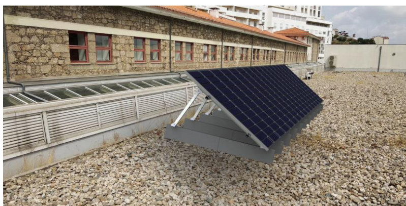
Figura 3.12 - Painéis PV instalados no terraço da Faculdade de Engenharia.
