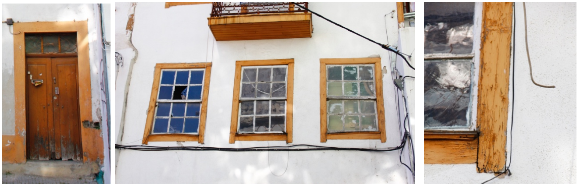
Figura 3.5.0 - Levantamento fotográfico de patologias no exterior
