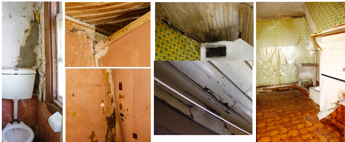
Figura 3.4.4 - Levantamento fotográfico das patologias do piso 1
