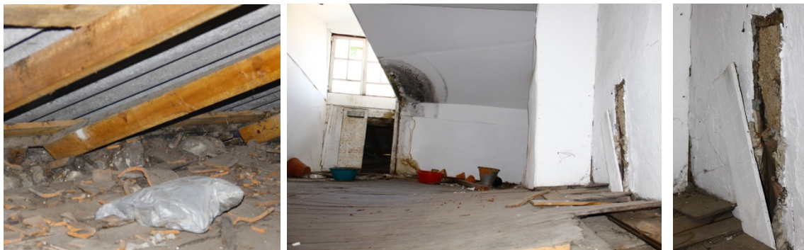
Figura 3.4.8 - Levantamento fotográfico das patologias do piso 3
