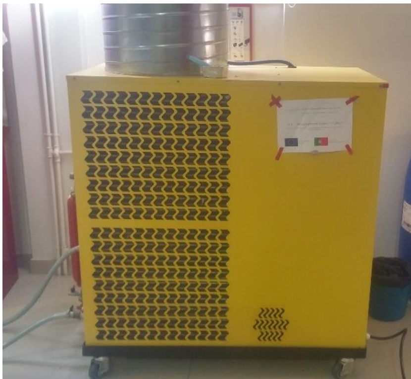
Figura 3.3: Chiller de refrigeração TAE evo 031.
