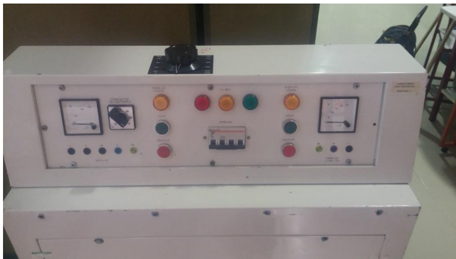
Figura 3.10: Fonte de tensão AC de regulação variável.
