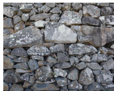
Imagem 55- Muro em alvenaria de pedra solta, São Jorge
