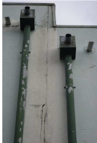
Figura 97 - Tubos de queda dos lotes 12, 13, 14 e 15. [59]
