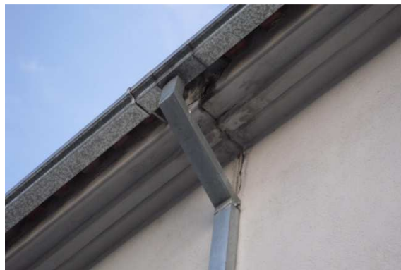
Figura 126 - Tubos de queda dos lotes 20, 21, 22 e 23. [59]
