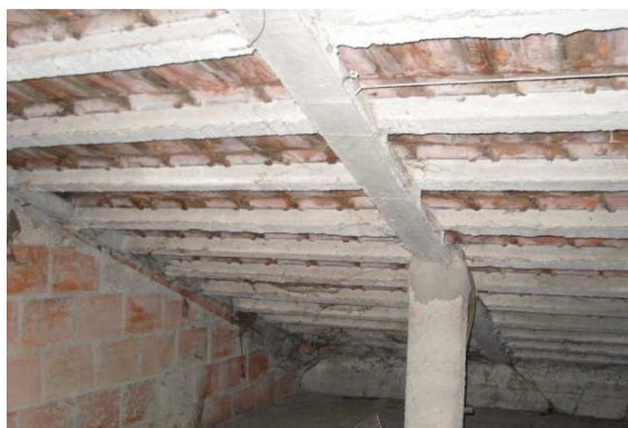
Figura 101 - Cobertura não impermeável dos edifícios. [59]
