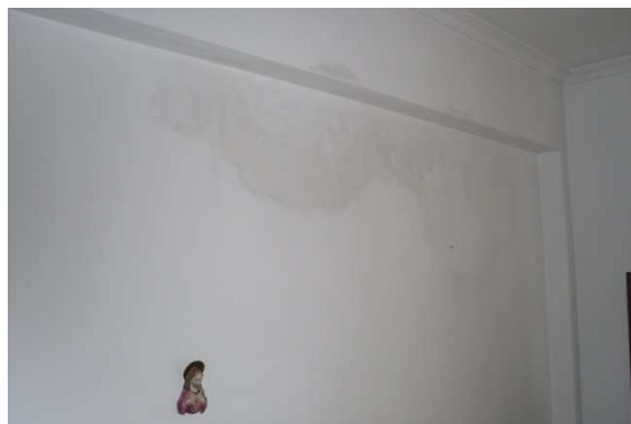
Figura 127 - Humidades nas paredes. [59]
