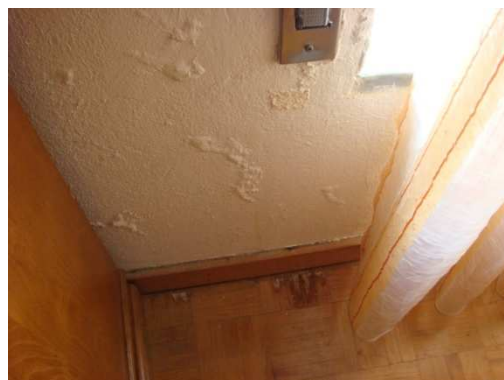
Figura 100 - Empolamento da tinta das paredes junto às janelas. [59]
