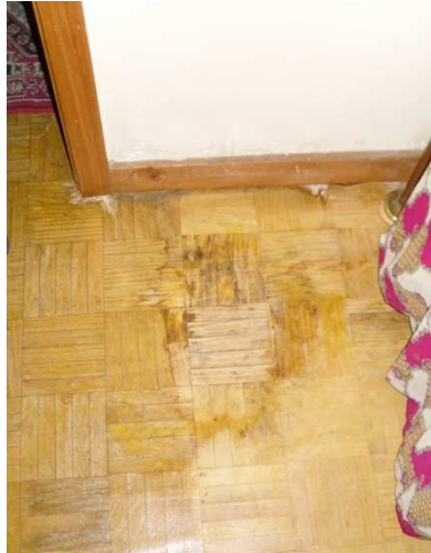
Figura 104 - Mancha branca de humidade num soalho do rés do chão. [59]
