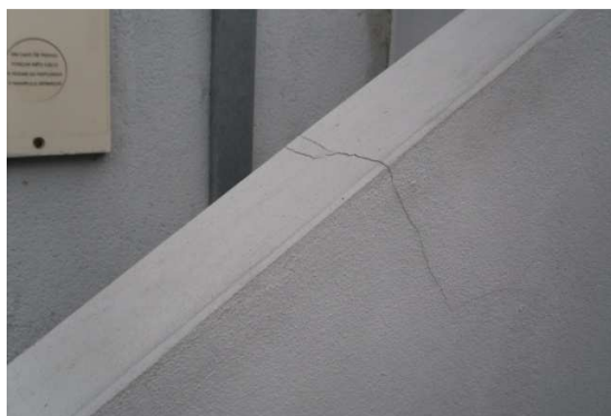
Figura 117 - Fissuração das paredes de acesso ao edifício. [59]
