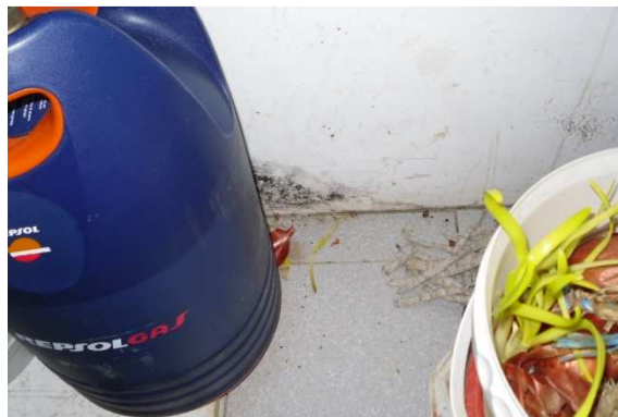
Figura 125 - Manchas de humidade visíveis no quintal dos moradores. [59]
