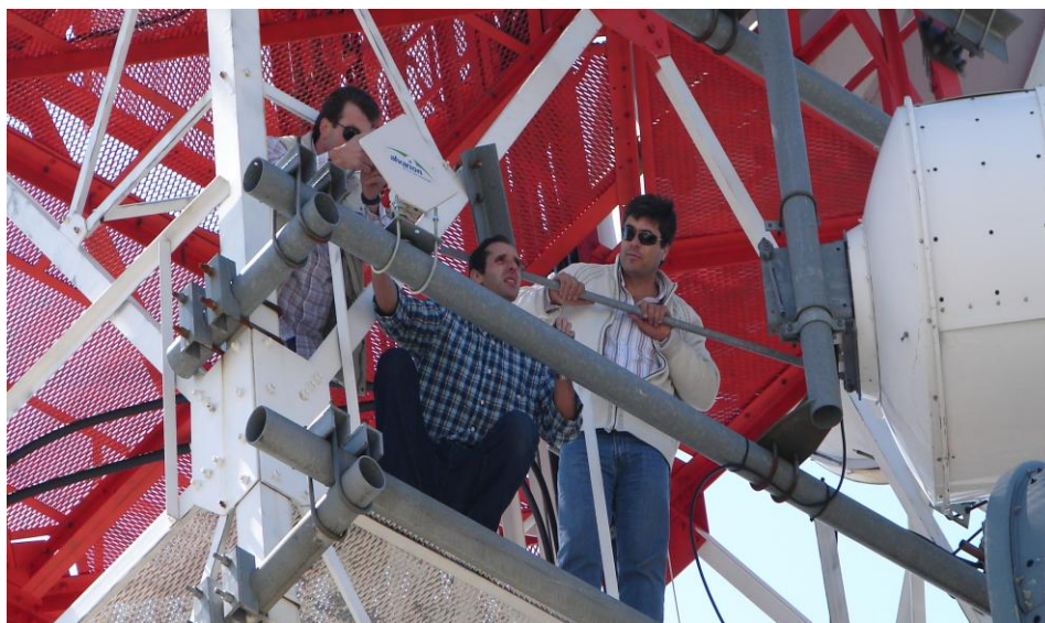
Figura 4.10 - Equipamento BreezeNet B na estação repetidora (Serra da Gardunha)
