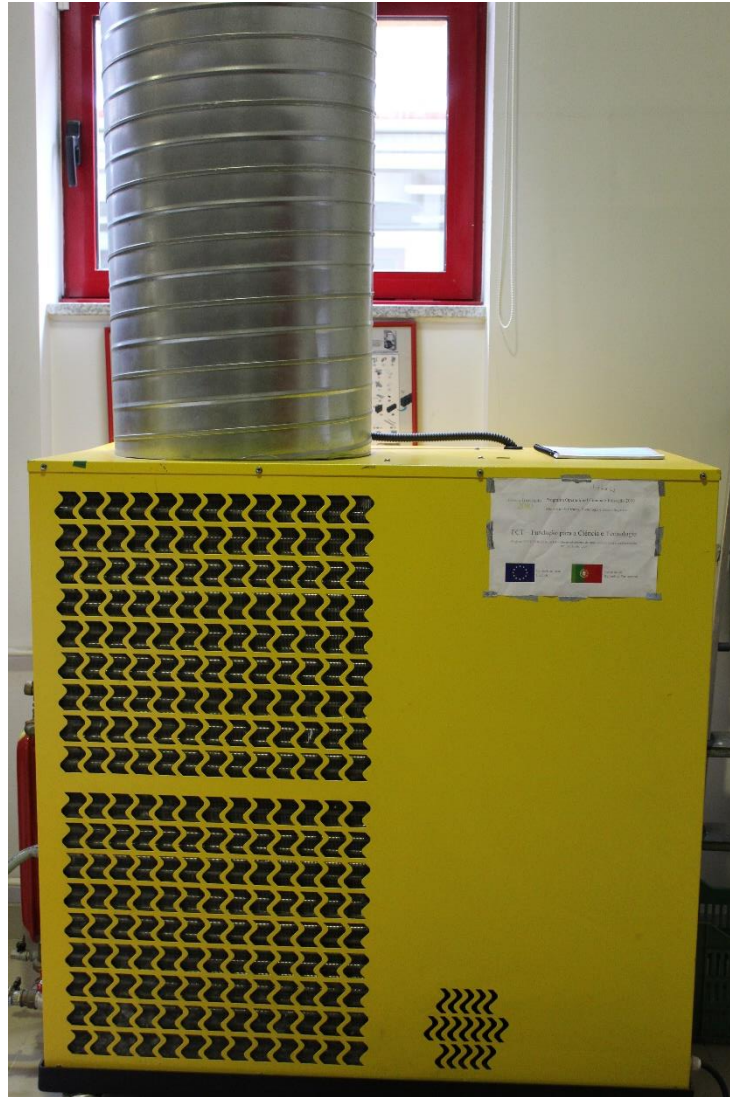
Figura 3.5: Chiller de refrigeração MTA TAE EVO 301
