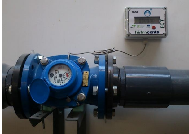
Fig. 3.6- Caudalímetro eletromagnético instalado na tubagem do circuito de alimentação
