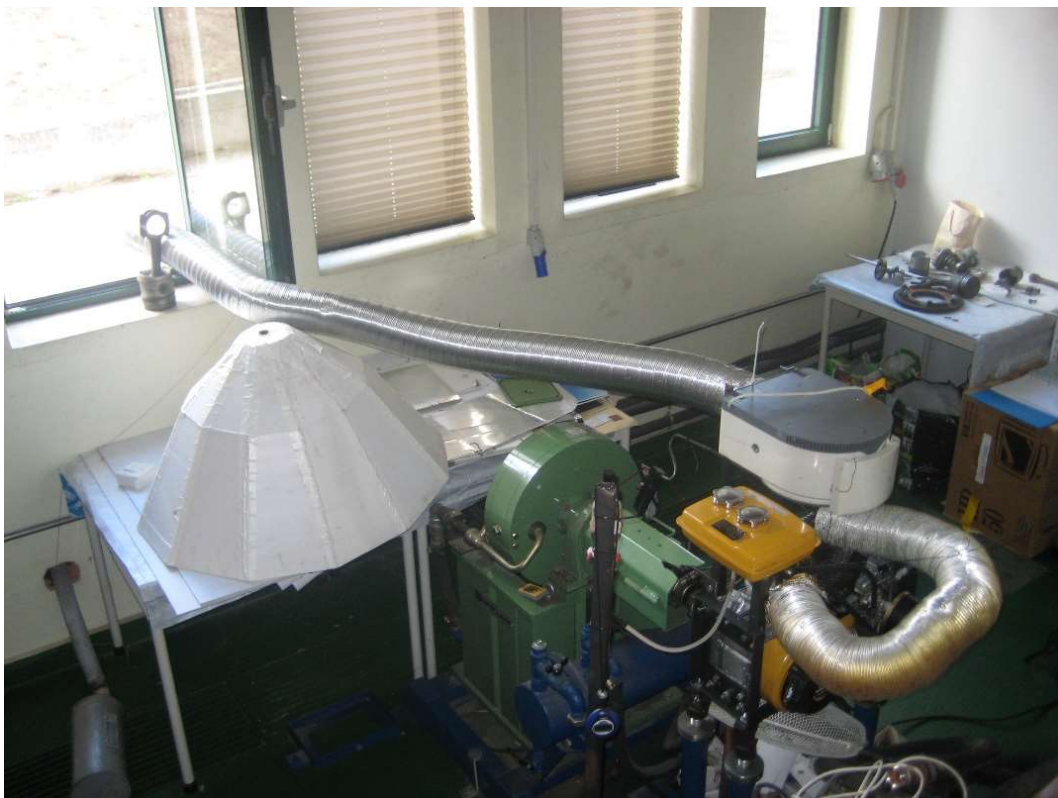
Figura 92 Vista geral do sistema de exaustão dos gases de escape e ventilação inferior.
