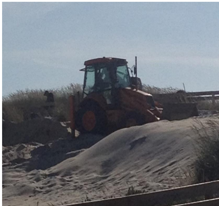
Ilustração 37- Levantamento de passadiço na praia da Vagueira. Foto tirada em: 02/05/2014
