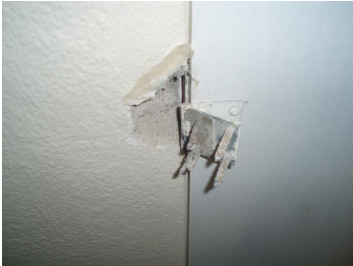
Figura 50: Exemplo de patologia onde a porta se desprendeu do revestimento.
