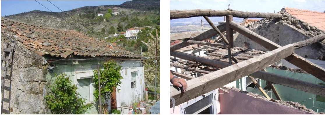
Figura 12: Exemplos dos principais problemas nas coberturas de duas águas [26].
