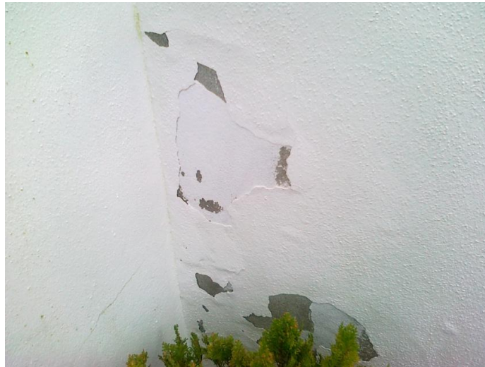
Figura 48: Exemplo de descascamento e empolamento da tinta.
