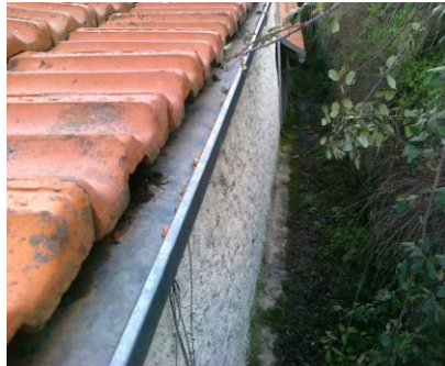
Figura 24: Existência de alguma sujidade numa das caleiras de uma habitação do bairro de São Vicente de Paulo.
