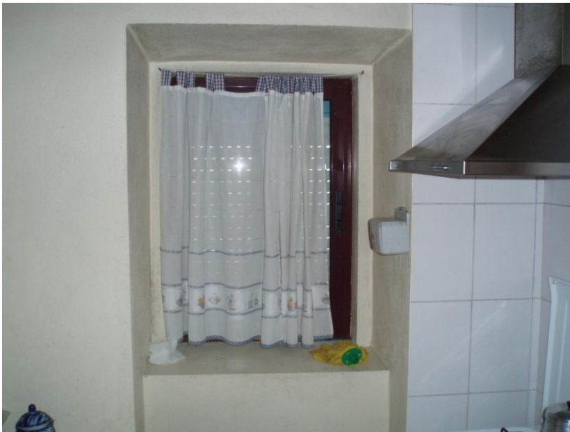
Figura 34: Espessura da parede diminui o espaço útil da cozinha.
