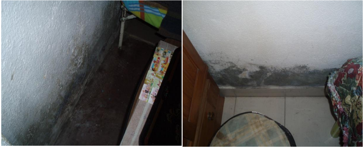
Figura 52: Exemplo de humidade ascensional numa habitação do bairro de São Vicente de Paulo.
