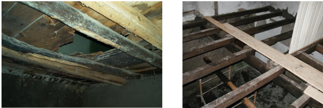
Figura 18: Reforço estrutural num dos casos onde se verificou elevado estado de degradação [26].
