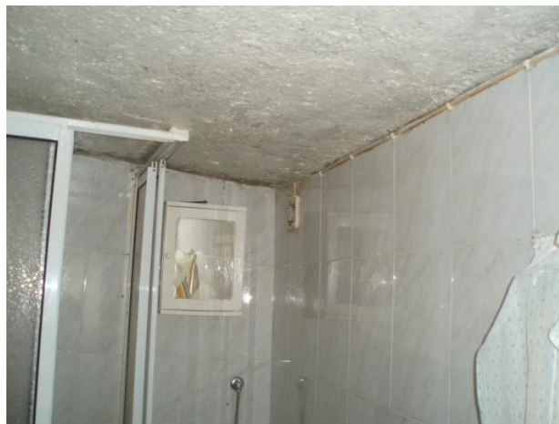
Figura 27: Humidade numa casa de banho de uma das casas reabilitadas no bairro de São Vicente de Paulo.
