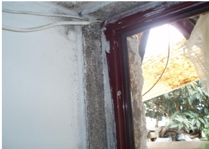
Figura 28: Aparecimento de humidade junto à porta de entrada da habitação numa das habitações do bairro de São Vicente de Paulo.
