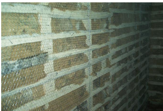
Figura 16: Exemplo de picagem numa das paredes do bairro de São Vicente de Paulo [26].
