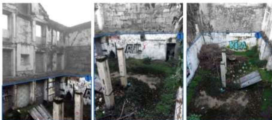
Fig.53 Levantamento fotográfico das patologias existentes no Espaço Número 1.
