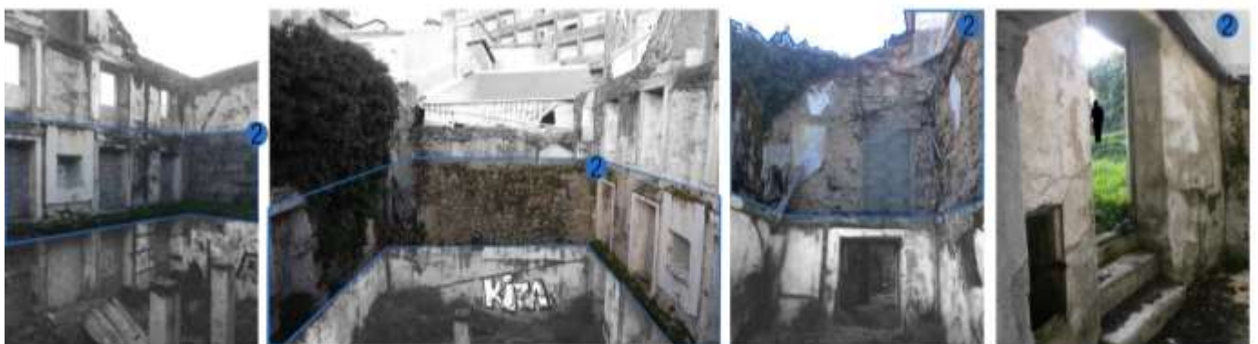
Fig.56 Levantamento fotográfico das patologias existentes no Espaço Número 2.
