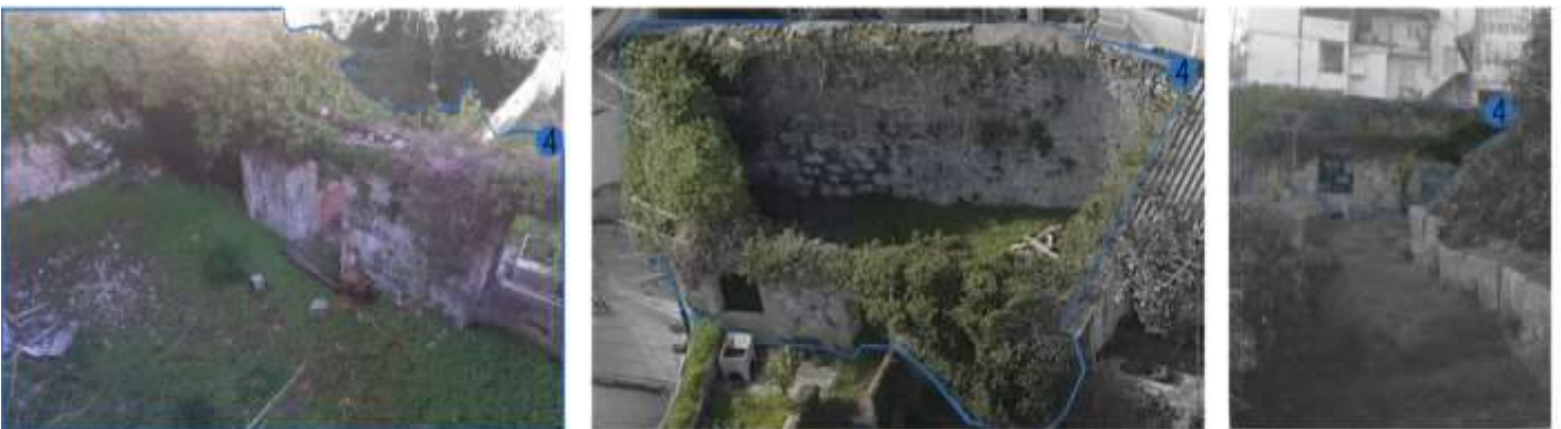
Fig62 Levantamento fotográfico das patologias existentes no Espaço Número 4.
