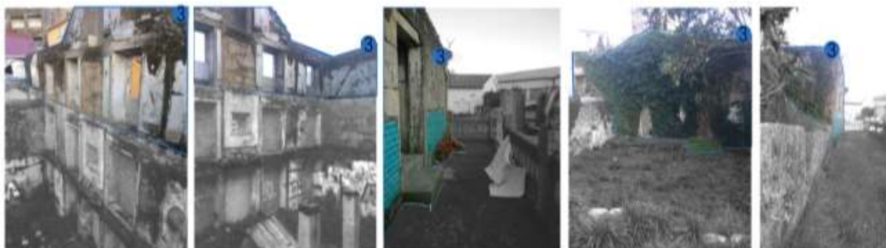
Fig.59 Levantamento fotográfico das patologias existentes no Espaço Número 3.
