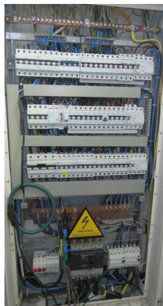
Figura 4.2 - Colocação do analisador de energia no quadro-geral da empresa auditada.
