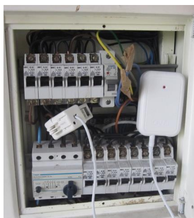
Figura 4.6 - Ligação da pinça amperimétrica ao quadro-principal.
