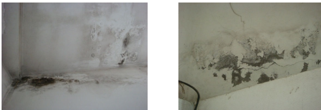
Figura 2 - Humidade na zona superior de uma parede de edifício (à esquerda). Empolamento da tinta interior, devido à humidade (à direita).
