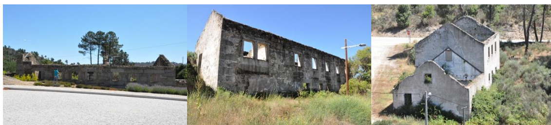
Figura 16 - Edifícios de habitação em ruínas (Fonte: Autor, 2012)
