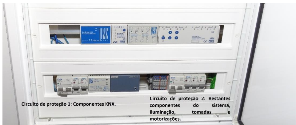
Figura 61: Quadro elétrico da maquete.
