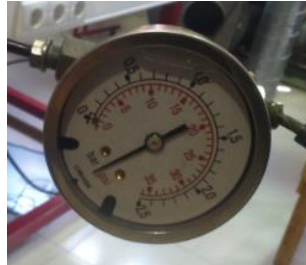
Figura 32 - Manómetro de pressão hidráulica.
