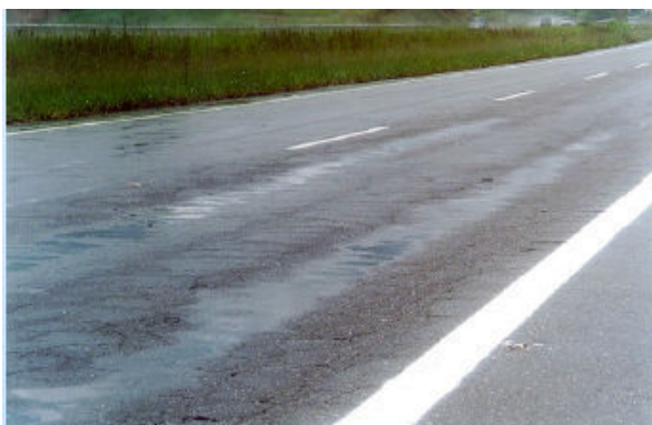
Figura 3.3 - Afundamento por compactação do tráfego (Bernucci, 2009)
