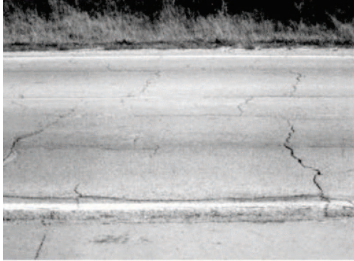
Figura 3.1: Pavimento com fendilhamento de alta densidade, elegível para tratamento superficial (FHWA, 1999)
