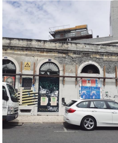
Figura 32 - Pormenor da fachada, visivelmente danificada; fotografia da autora
