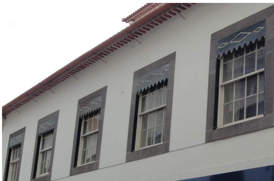
Figura 34 -Conjunto de janelas com caixilharia de guilhotina, com moldura simples e lambrequins (Autora)
