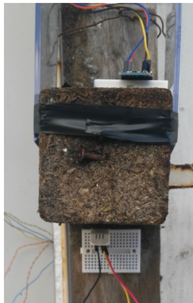
3.24-Sensor de luminosidade (em cima) e sensor exterior de humidade e temperatura (em baixo)
