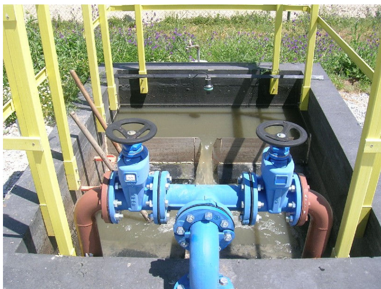
Figura 2.12 – Caixa de entrada para distribuição de caudal com tubagem de recirculação
