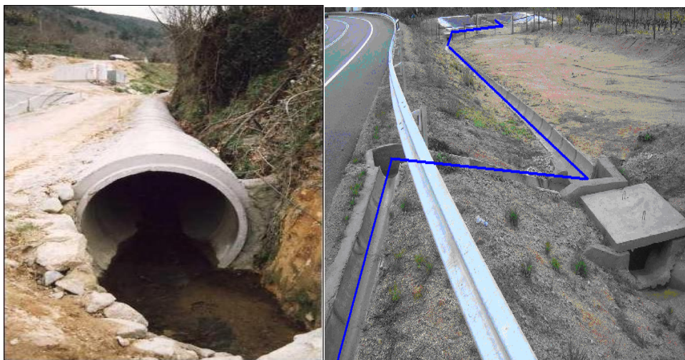
Figura 2.2 - Valetas para recolha de águas pluviais
