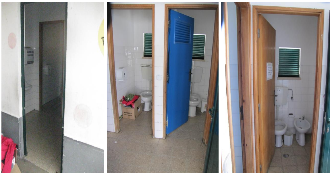
Fotografias das Casas de Banho com destaque para os problemas detetados.
