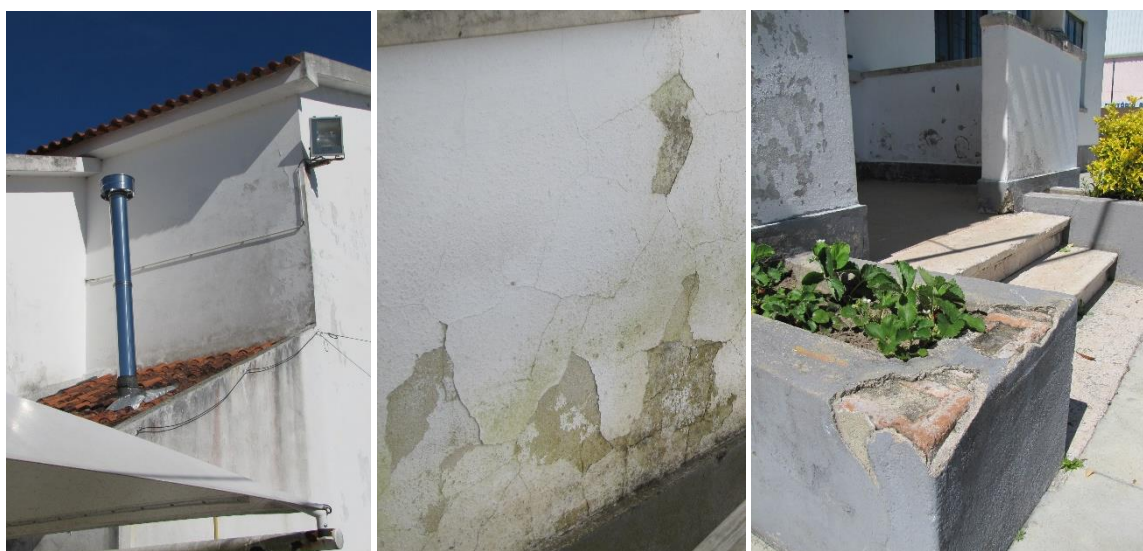
Fotografias do Alpendre de Entrada com destaque para os problemas detetados.
