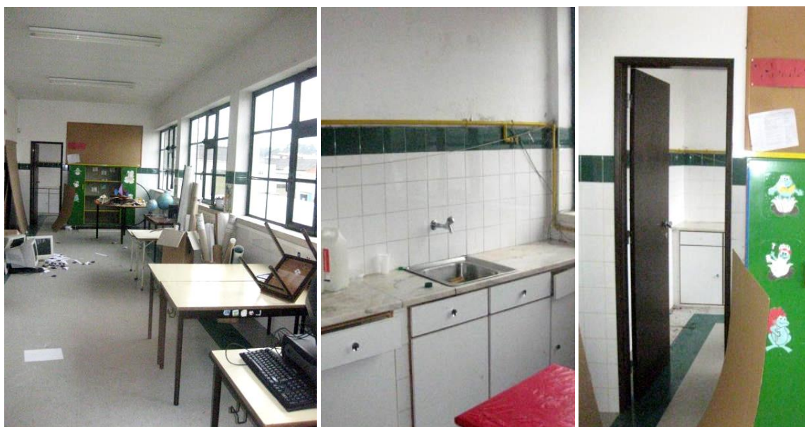
Fotografias da Sala de Artes Plásticas com destaque para os problemas detetados.
