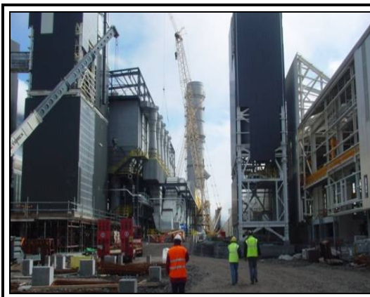
Figura 4.34 – Estruturas, condutas e chaminé (Alcoa, Islândia).
