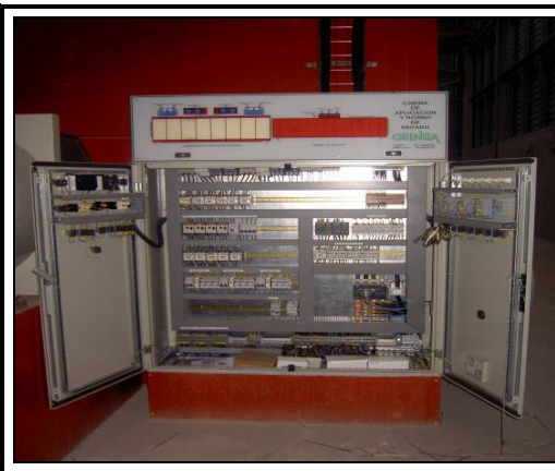
Figura 4.27 – Quadro eléctrico da estufa.
