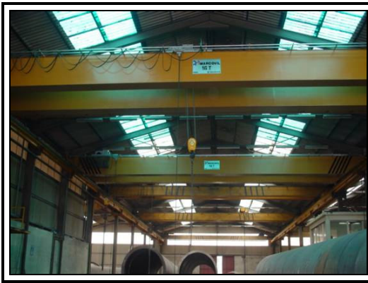
Figura 4.10 – Pontes rolantes de 5 e 16 ton.
