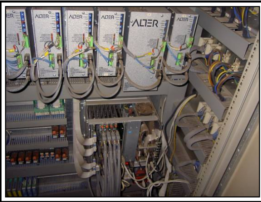
Figura 4.9 – Quadro eléctrico da máquina FICEP DZB903.
