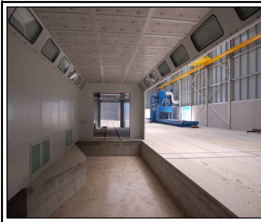
Figura 4.24 – Interior da estufa e túnel de decapagem ao fundo à direita.
