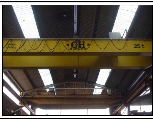
Figura 4.11 – Pontes rolantes de 25 e 32 ton.
