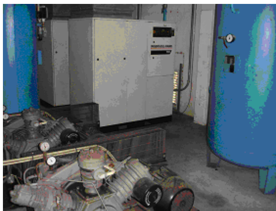
Figura 12.1. – Central de ar comprimido.
