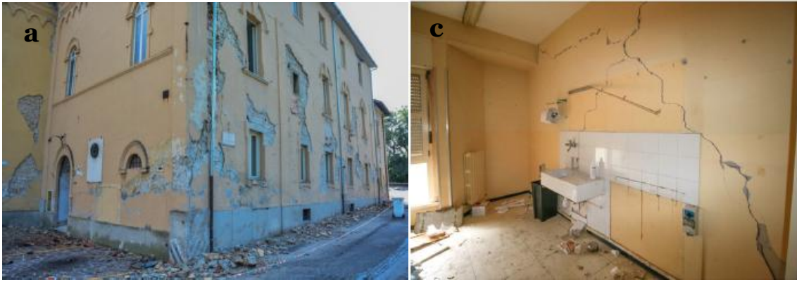
Figura 23 Danos nas paredes externas e divisórias do complexo hospitalar de Amandola, Itália. Adaptado de [44]
