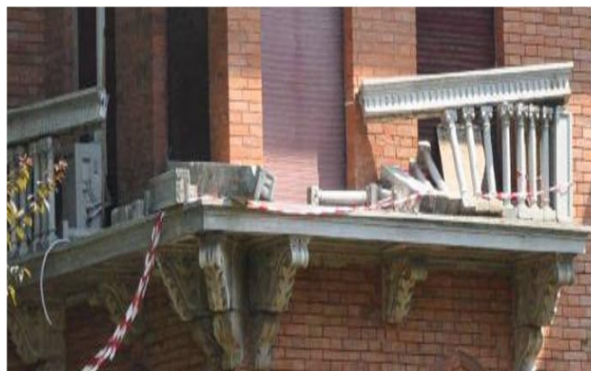
Figura 18 ) colapso de parapeitos. Adaptado de [39].
