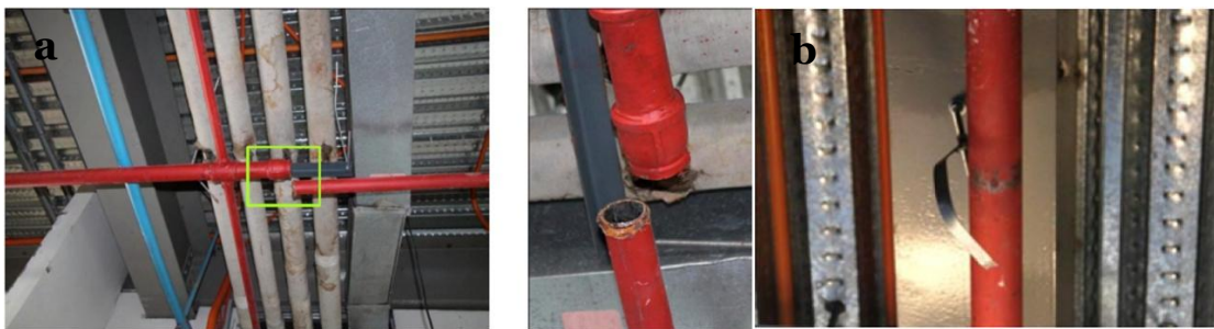
Figura 20 Danos em tubagens suspensas, a) falha nas juntas e b) falha na cinta de suporte da tubagem. adaptado de [41]
