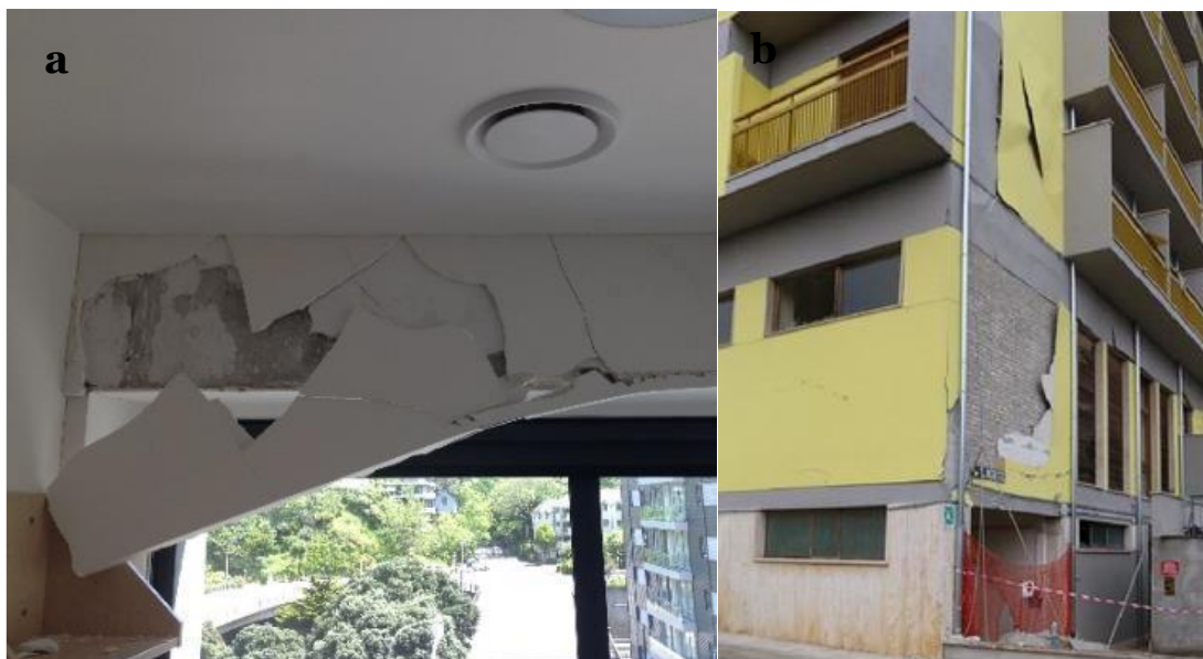
Figura 8 a) Danos em acabamentos de gesso (a)[30] e de revestimento em reboco de cimento (b)[3]
