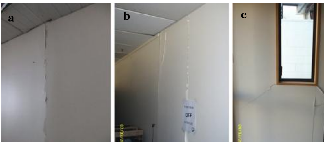
Figura 6 Danos típicos observados em paredes de gesso cartonado, a) e b) fissuração no painel e nas juntas entre painéis, c) fissuração diagonal propagada adjacientemente a abertura. Adaptado de [27].
