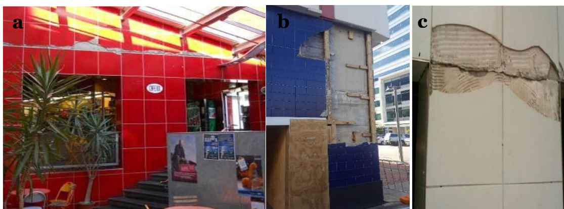
Figura 7 Fraturas nos azulejos colocadas na zona de viga (a) e pilar (b), fratura na conexão da viga ao pilar (c). Adaptado de [17] [30]
