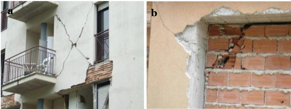
Figura 2 Fissuras diagonais adjacentes as aberturas (a)[12], Esmagamentos e compressão dos cantos (b) [13].
