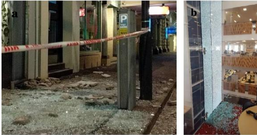
Figura 10 Estilhaçamento de vidros localizados na fachada (a) e divisória interna (b). Adaptado de [30].
