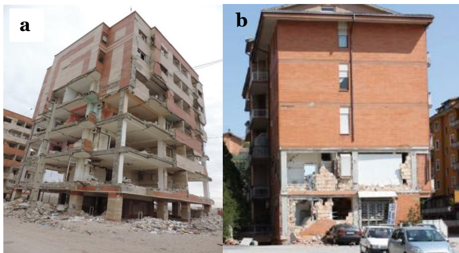
Figura 5 Falha do piso fraco. a) Colapsos extensos em diversas paredes dos primeiros pisos [25] e b) paredes parcialmente colapsadas [15].
