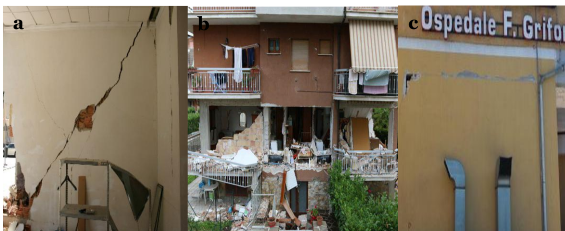
Figura 1 Fissuras diagonais (a)[19] falha total dos painéis (b), desconexão do painel a estrutura circundante (c) [3].
