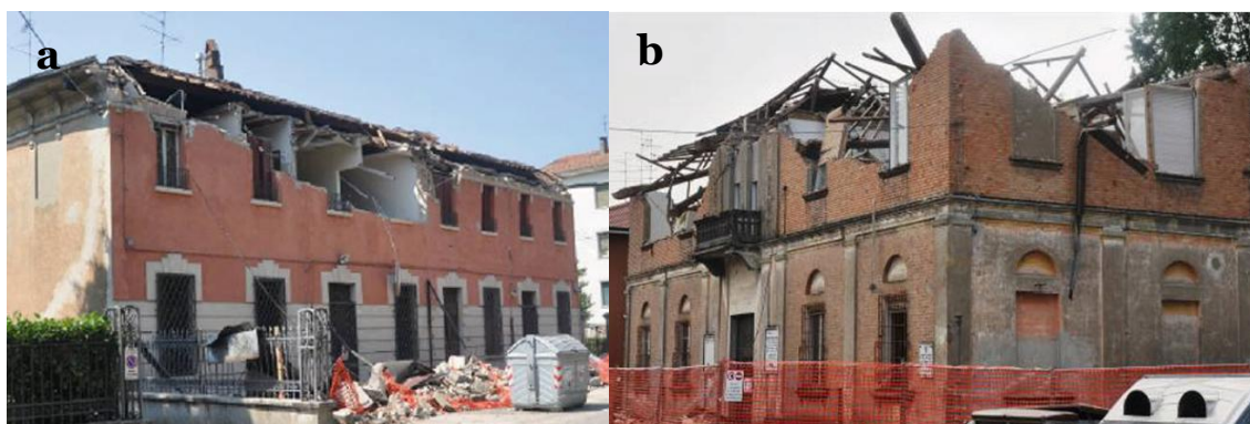
Figura 16 Colapsos da cobertura e a influência do empuxo deste sobre as fachadas, originando o colapso parcial da alvenaria para fora do plano da parede “interação parede-cobertura”. Adaptado de [39]
