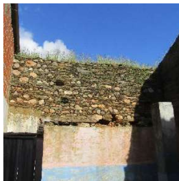
Fig. 24 - Interior em ruínas (pormenor); junto à estrada N18-8 (Castelo Branco), 2018
