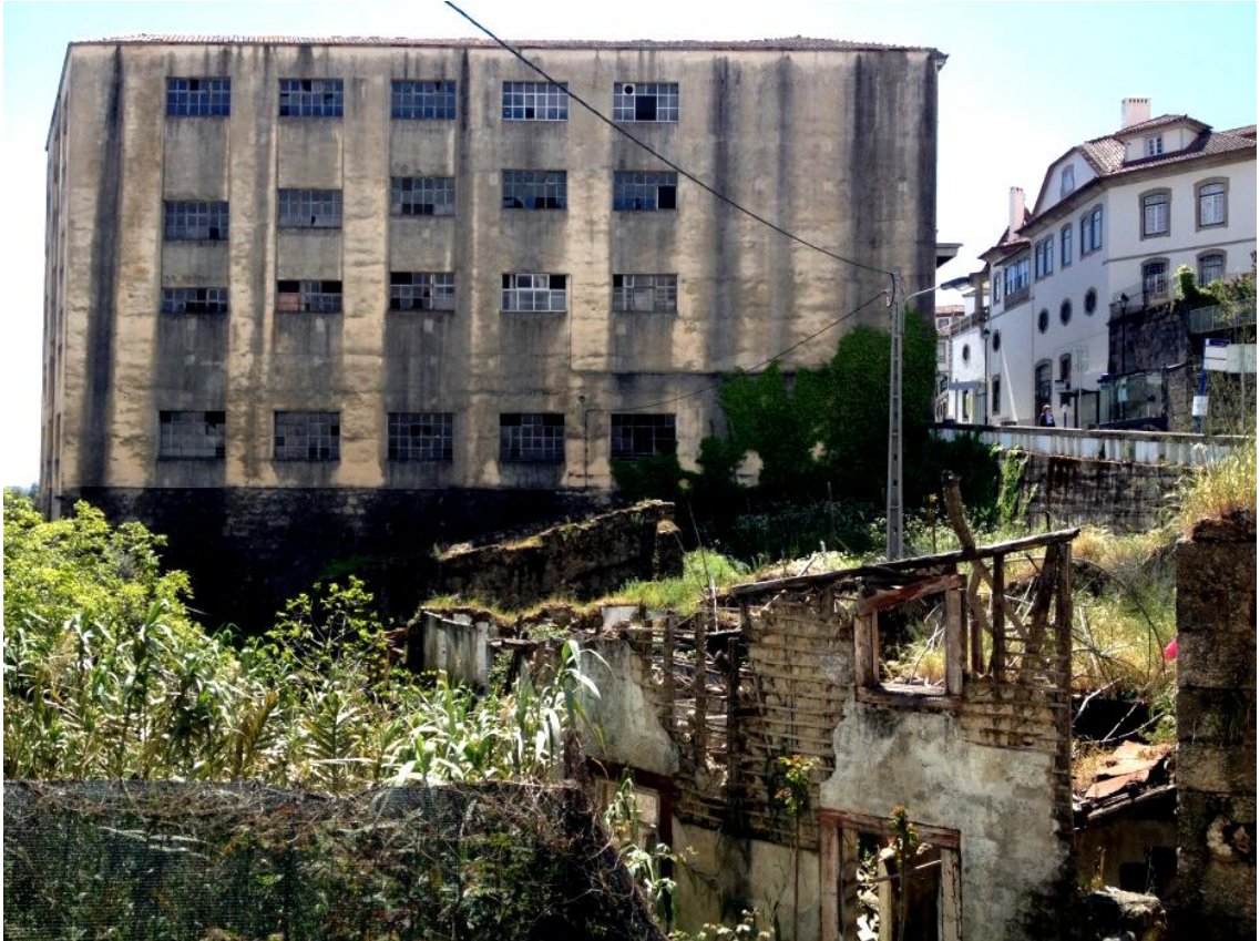
Fig. 40: Fachada com pouco valor arquitectónico. da Garagem de S. João, Covilhã.
