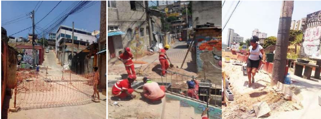
Figura 1 : Obra de instalação de canaletas/URBEL (à esquerda) - Participação dos moradores à direita) Vila Estrela - Setembro de 2019. Fotos: Elaine Rocha
