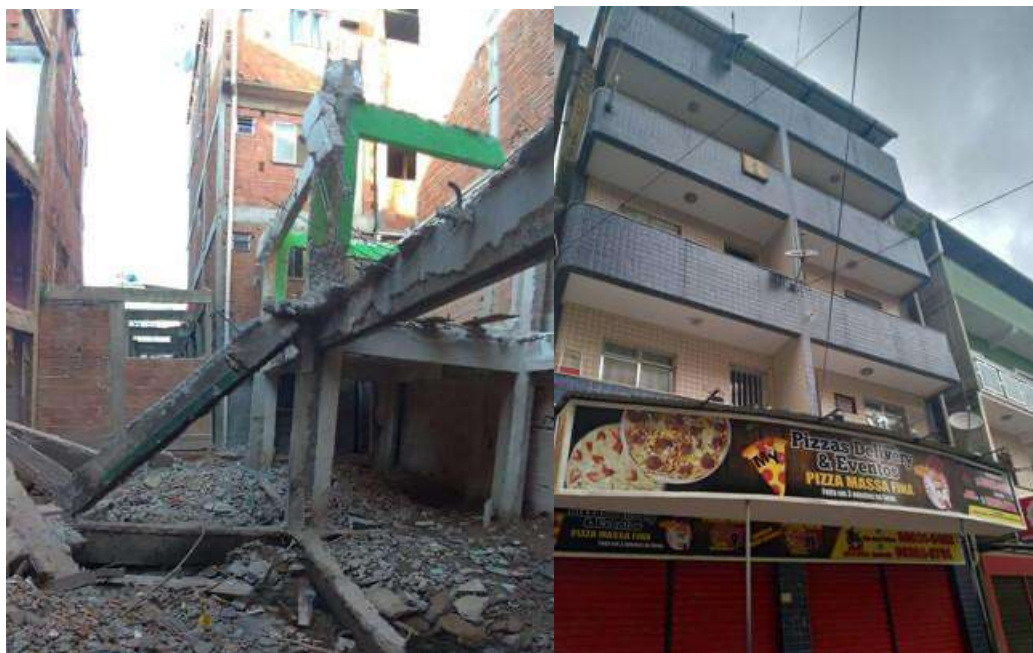
Figura 5: Edifício inclinado que foi parcialmente demolido (à esquerda) e fachada de edifício com bom acabamento (à direita). Fonte: Acervo Pessoal, 2019.
