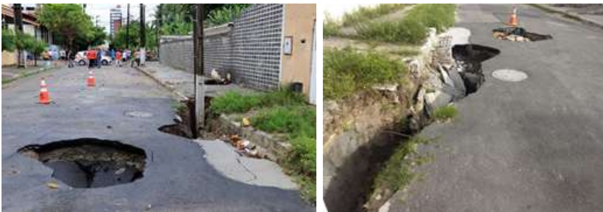
Figuras 07 e 08: Rachaduras nas vias, resultantes do processo de subsidência do solo. Fonte: (1) Fecomércio AL, 2019
