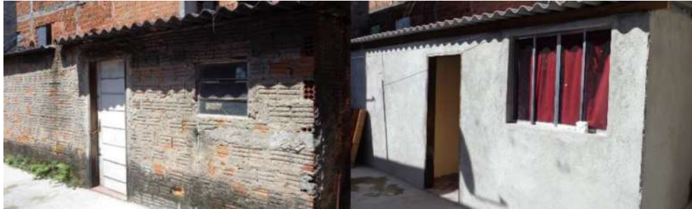
Figura 2: Exemplo de casa antes e depois da reforma, em Heliópolis. Fonte: Acervo da HPH.
