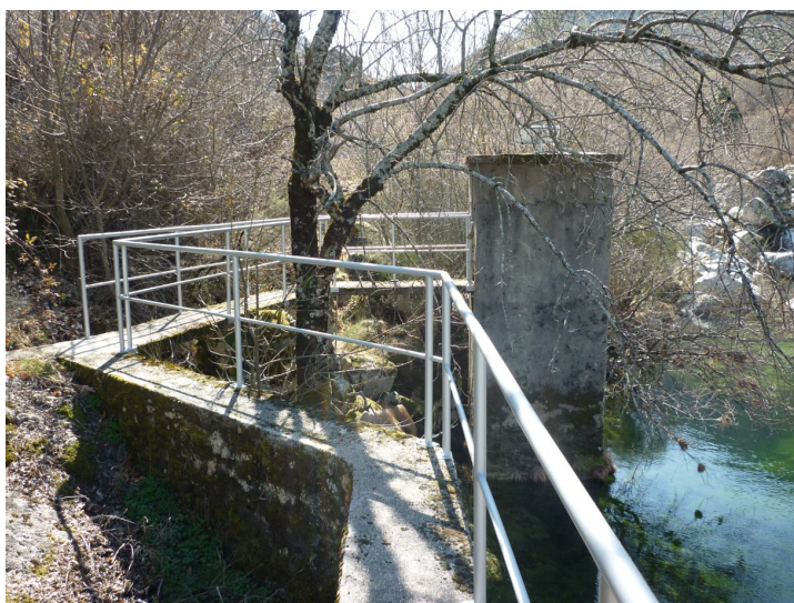
Figura 2.4 - Cabina na Estação Hidrométrica (Secção de Referência)
