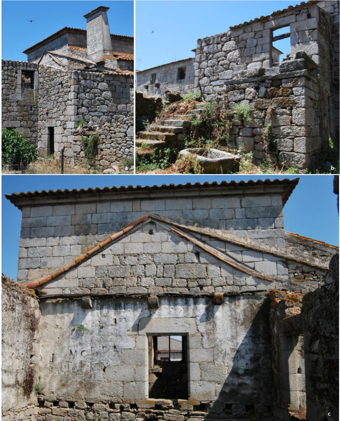
Figura 34 - (a) Corpo saliente da fachada Este; (b) Escada exterior; (c) Vestígios da cobertura
