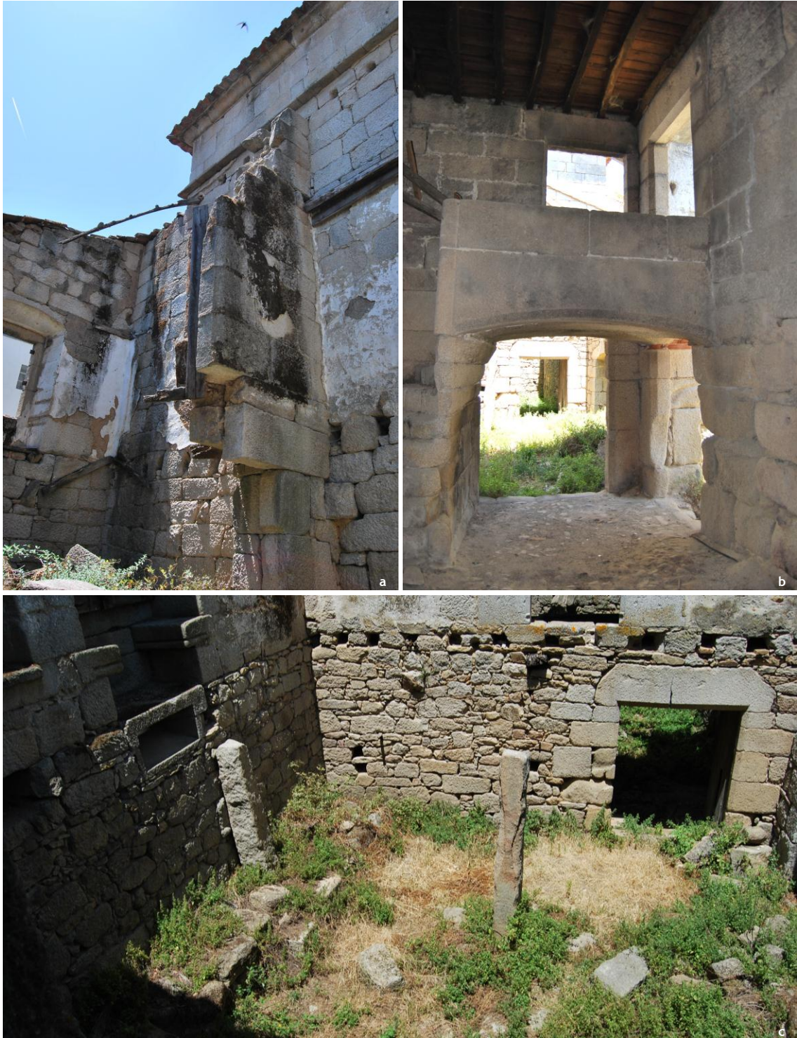
Figura 37 - (a) Ruína da parede interior; (b) Pavimento de entrada de pedra; (c) Interior com vegetação
