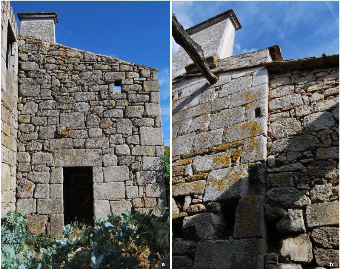
Figura 35 - Paredes do corpo mais saliente: (a) Imagem da parede exterior encostada; (b) Imagem da parede interior encostada
