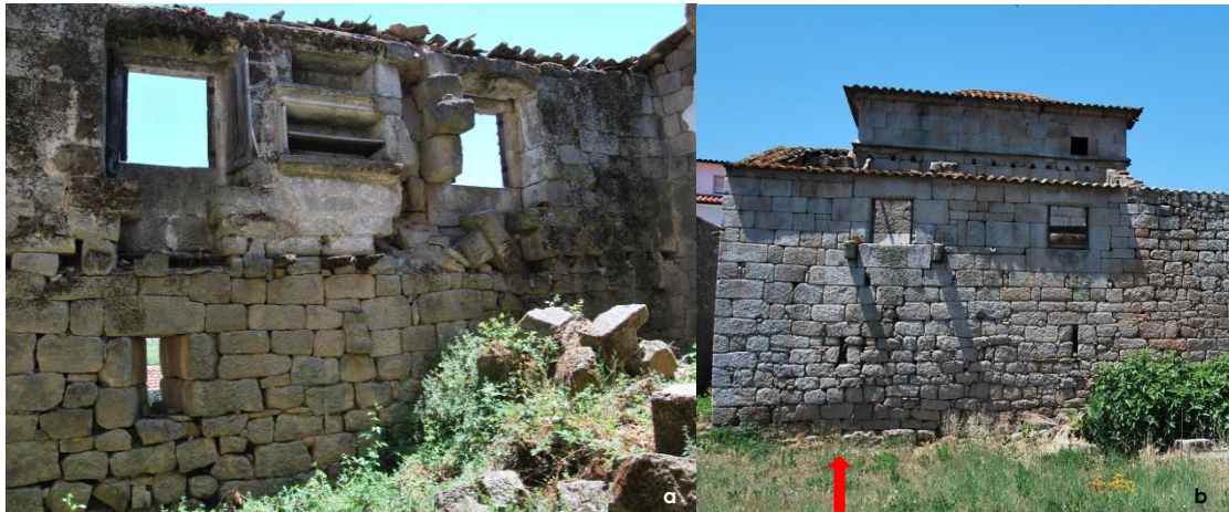
Figura 24 - (a) Degradação interior da fachada Nascente; (b) Deformação da parede
