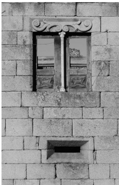
Figura 15 - Janela renascentista e a fresta horizontal, Solar dos Távoras
