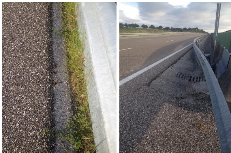
Figura 2.2 - Exemplos de drenagem de águas pluviais na autoestrada A1 (Portugal)
