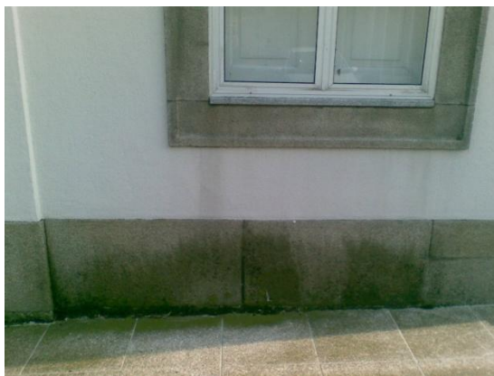
Figura 3.3 - Humidade ascensional em parede
