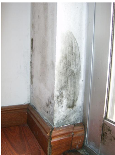
Figura 3.10 - Humidade devido a condensações superficiais.
