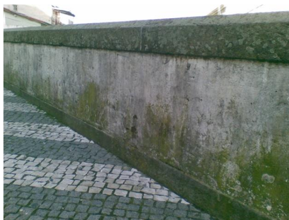
Figura 3.4 - Humidade ascensional em muro
