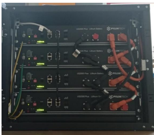
Fig. 56 - Banco de baterias US2000 Plus da Pylontech.
