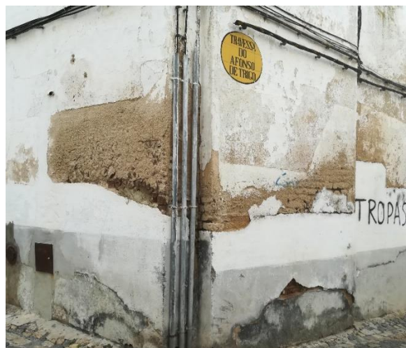
Figura 2 - Exemplo de Parede de Alvenaria em Adobe, Travessa do Afonso de Trigo, Évora
