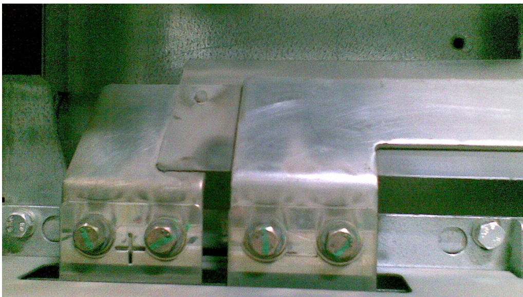
Figura 3.15 – Barramento DC com muita sujidade e indícios de pontos quentes e picagem.
