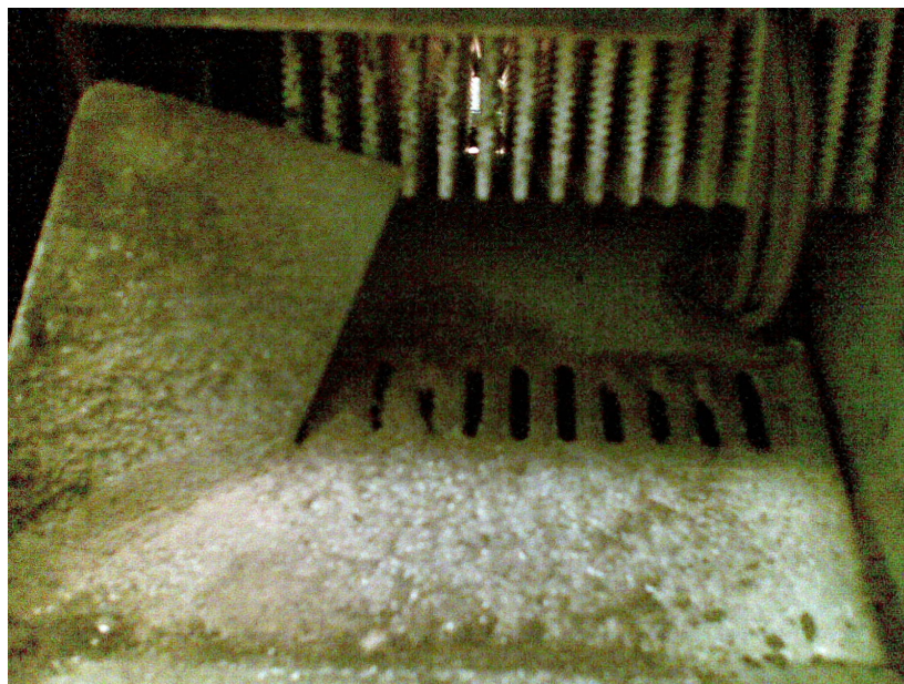
Figura 3.14 – Dissipadores de calor dos módulos de potência (rectificação e inversão) entupidos.
