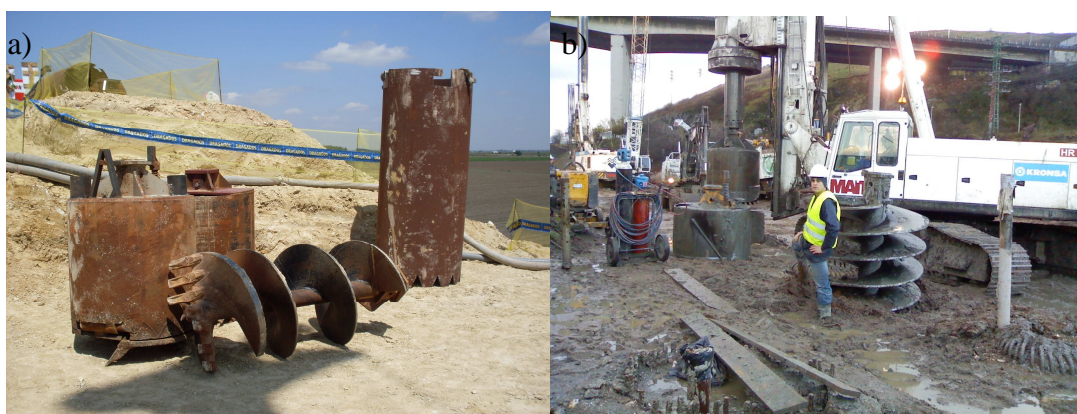
Fig. 1.24 – a) e b) Detalhe de trados de diâmetros 1000mm e 1500mm aquando das obras da linha de alta velocidade Sevilha – Jerez de la Frontera – Espanha (2009) e do túnel “cut and cover” Bilbao - Espanha (2009) respectivamente.
