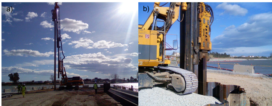
Fig. 1.11 – Exemplo de cravação de estacas prancha aquando o decorrer das obras de ponte sobre o Ebro em Deltebre – Espanha, a) panorama geral e b) pormenor da garra de cravação (2009).
