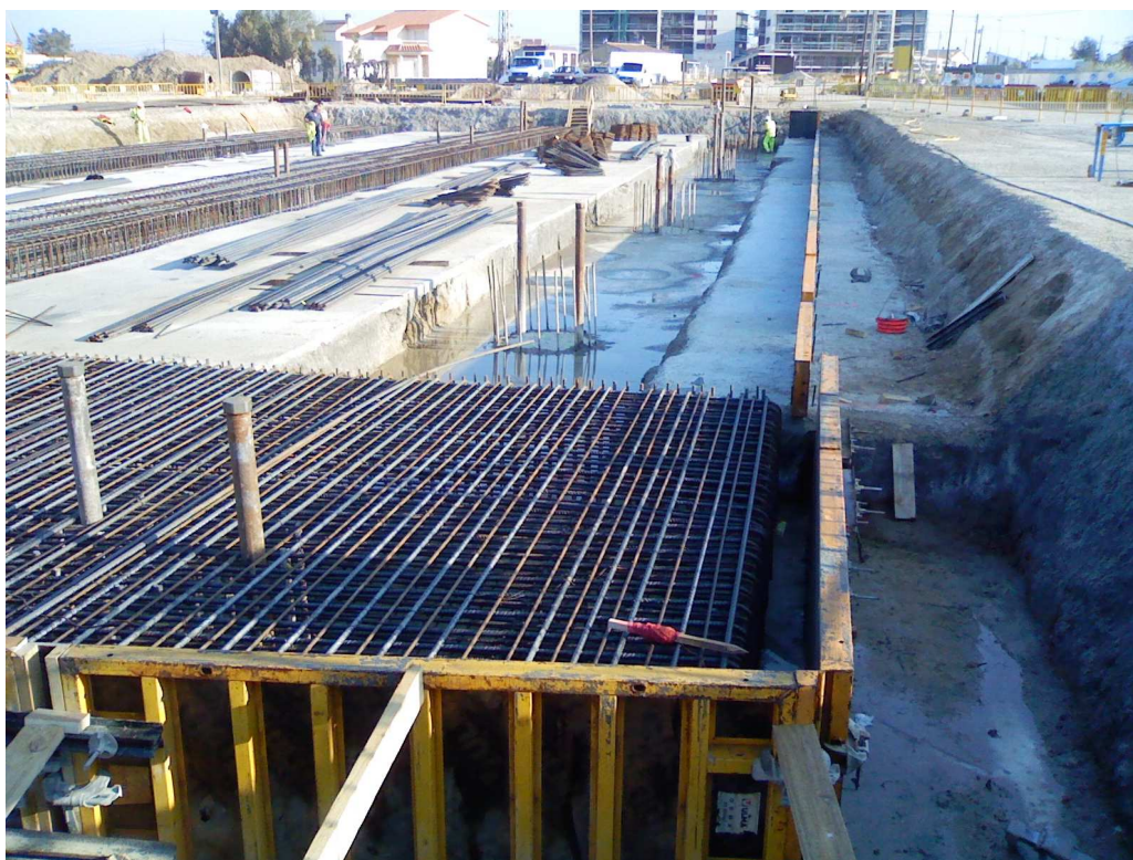
Fig. 3.4 – Exemplo de laje de encabeçamento de um grupo de 15 estacas de grande diâmetro a quando dos trabalhos da ponte sobre o Ebro, Deltebre – Espanha (2009).
