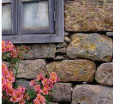
Fig.138 | Tufo em fachada
