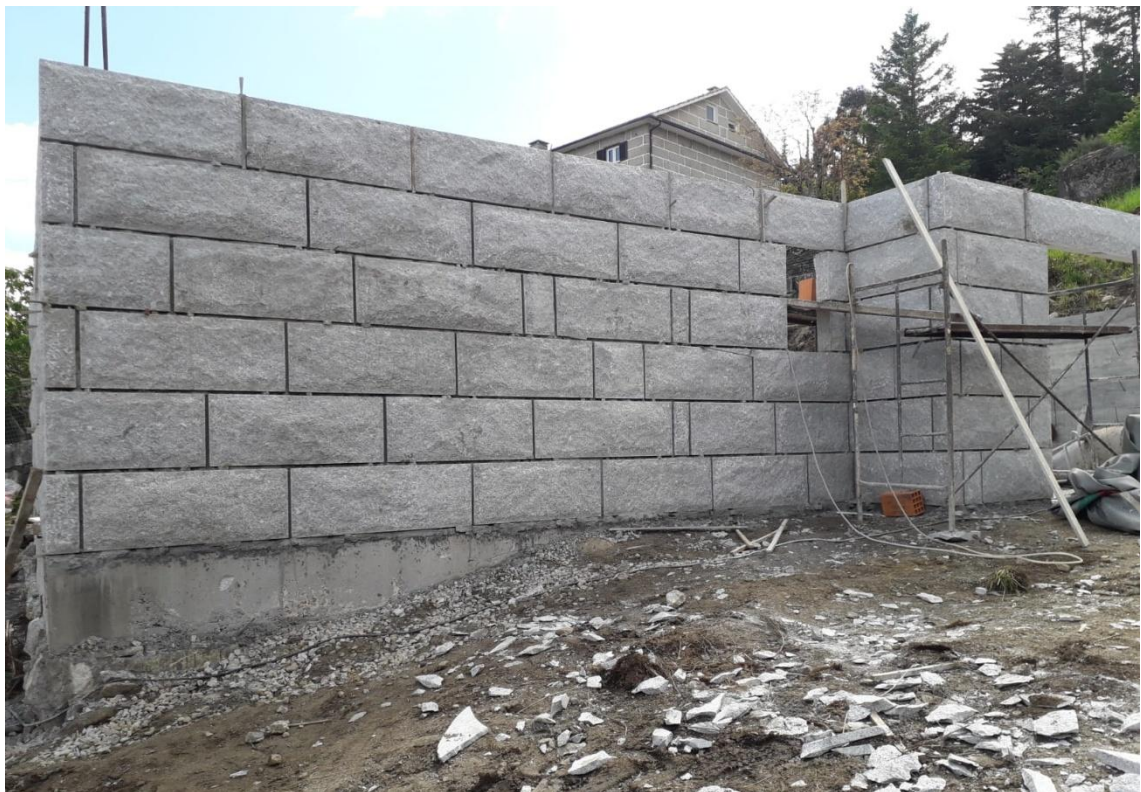
Figura 65| Exemplo de fachada sem planeamento prévio dos blocos (Autora, 2024)
