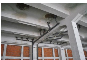
Fig. 106 Canos – instalação para os pisos superiores
