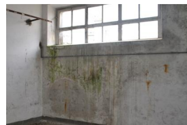
Fig. 39 Sinais de infiltrações
