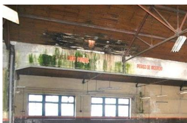
Fig. 40 Abertura na cobertura
