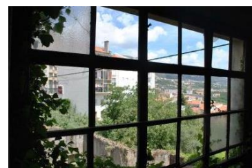
Fig. 42 Vão com falta de vidros
