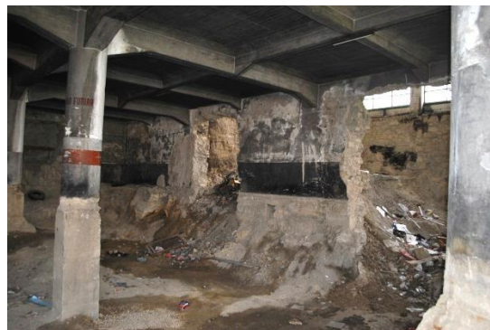
Fig. 21 Zona em pior estado do piso -1
