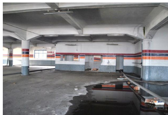
Fig. 30 Água sob o piso 1
