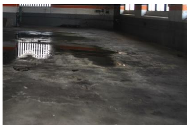
Fig. 38 Chão com sinais de desgaste
