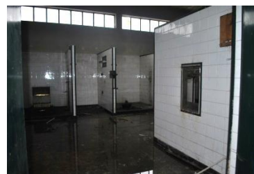
Fig. 105 Sala inundada de água da chuva
