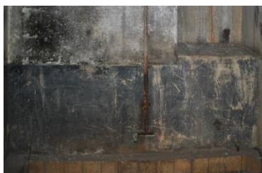
Fig. 37 Desgaste na parede do piso 2
